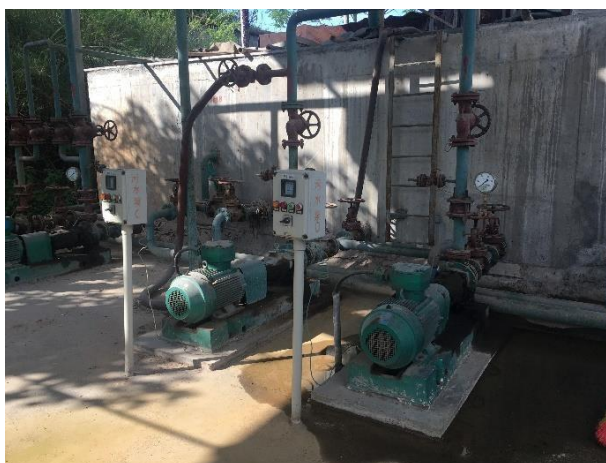
图 11 污水处理站水泵
