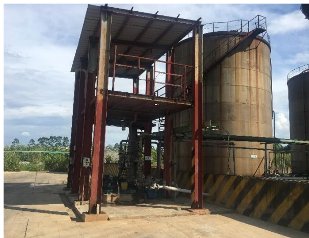
图 4 双氧水储罐泵站情况
